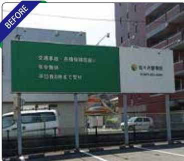
看板上部は木の腐敗が進んでいました。
